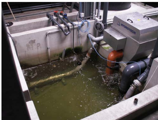
Alles im Blick: In der weitgehend offenen Anlage erkennen Fachleute sofort, ob alles perfekt und störungsfrei läuft.
